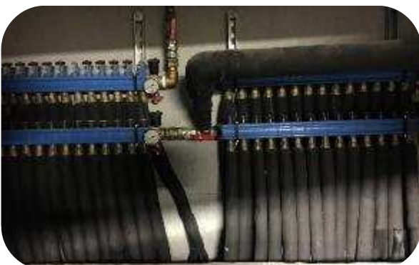
Collecteur de sondes géothermiques
